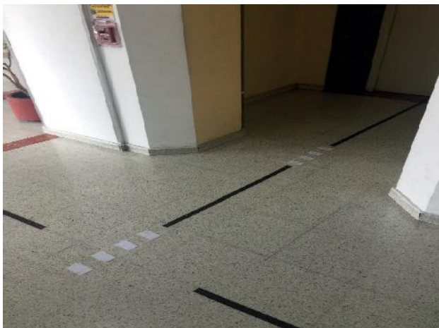
Figura 16. Entrada al ascensor línea guía magnética (Fuente autores 2016).
