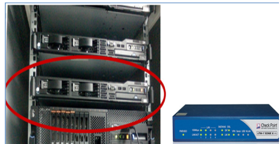
Fig. 6. Ubicación en el rack del Open Server X3550 de IBM (firewall sede principal izquierda) y vista frontal del firewall UTM-1 EDGE (firewall sucursales derecha).
