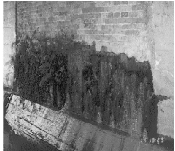
Figura 3. Daños en los Estribos de los Puentes. Fuente: INVIAS, Grupo de Puentes
