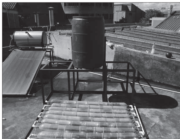
Figura 7. Fotografía de los dos calentadores a prueba. En primer plano el calentador con envases PET, al fondo el calentador solar de placa plana. Fotografía tomada a las 2:30 pm del día de instalación, donde se aprecia que no hay proyección de sombras.
