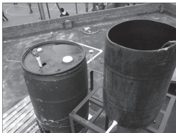
Figura 4. Fotografía de los dos tanques del calentador solar. Fuente: Elaboración propia
