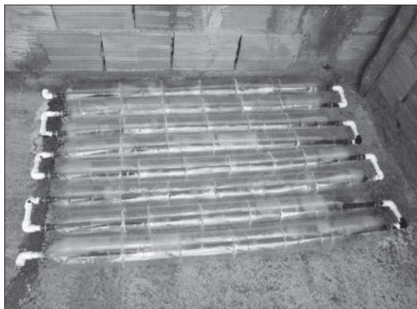
Figura 3. Fotografía del colector solar con envases PET y tubería PVC en serie.
