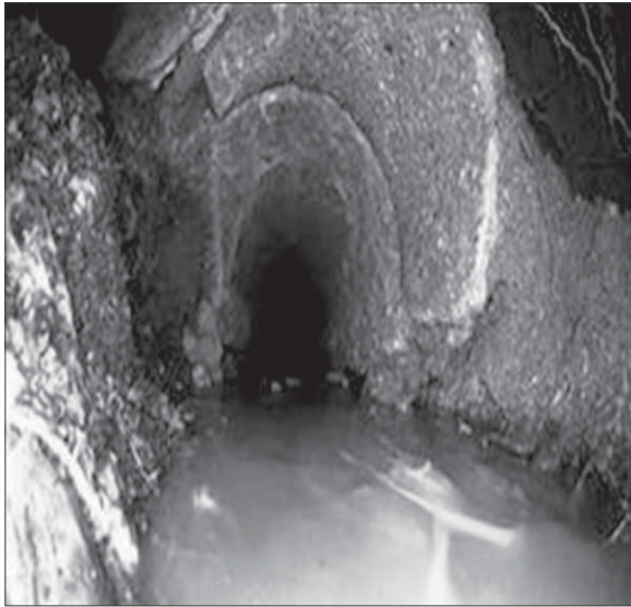
Figuras 3. Socavones producto del fenómeno de colapso por humedecimiento
