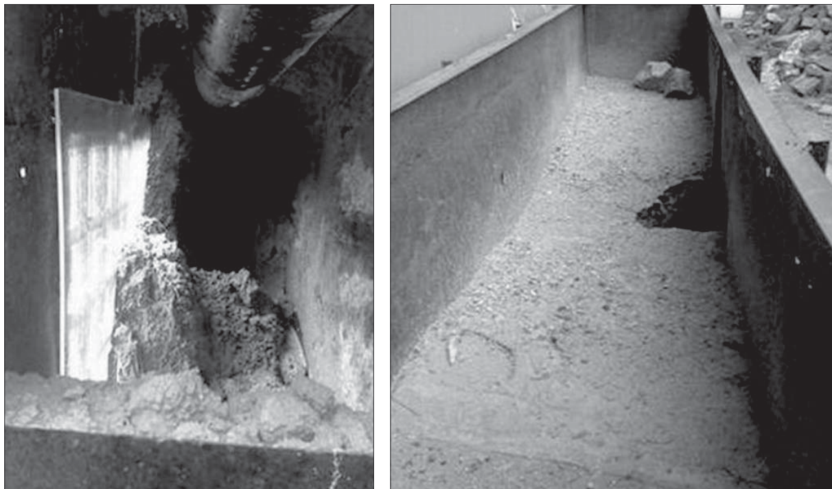
Figura 10 Fenómeno de colapso
