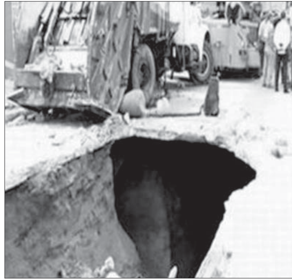
Figuras 4. Socavones producto del fenómeno de colapso por humedecimiento
