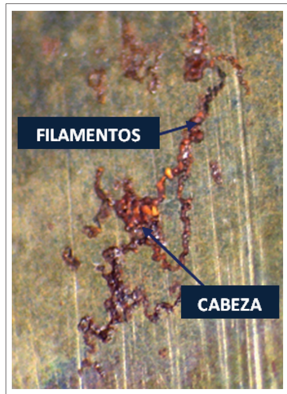
Figura 3. Corrosión localizada filiforme
