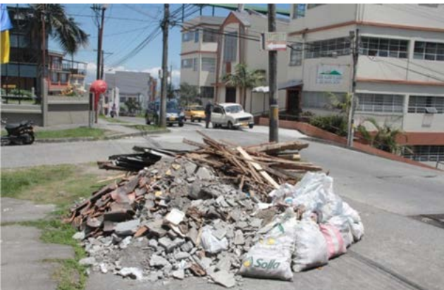
Figura 3. Vertimiento ilegal de RC&D en Santiago de Cali.
