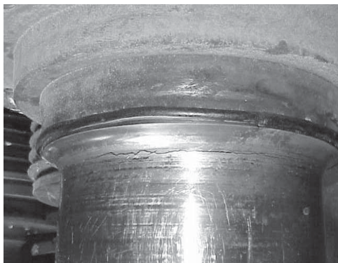
Figura 4. Eje con cordones de soldadura longitudinales revelados por corrosión y con una fisura en el escalón del guijo
