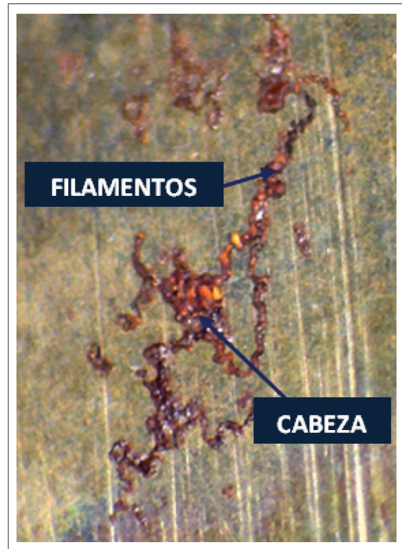
Figura 3. Corrosión localizada filiforme
