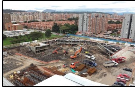
Proceso de Construcción en Obra VIS (Vivienda de Interés social) Fuente: autoras
