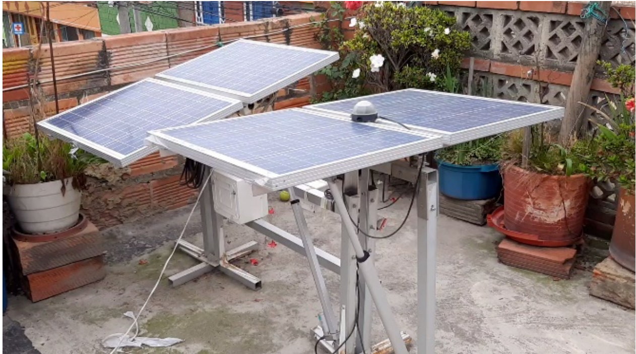
Figura 3. Sistema de medición montado sobre una estructura soporte de aluminio.
