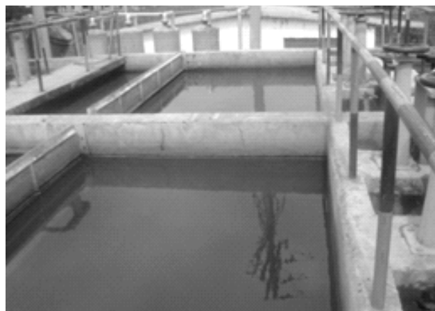
Figura 4. Etapa de dosificación en el proceso de coagulación-floculación
