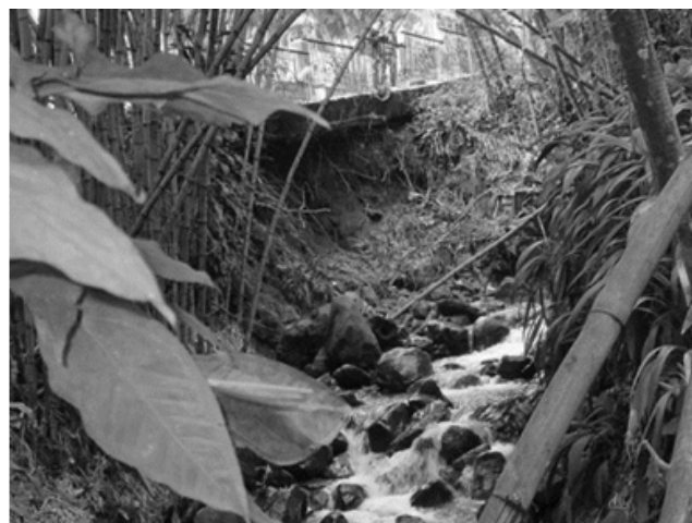
Figura 3.- Talud Erosionado en margen derecha
