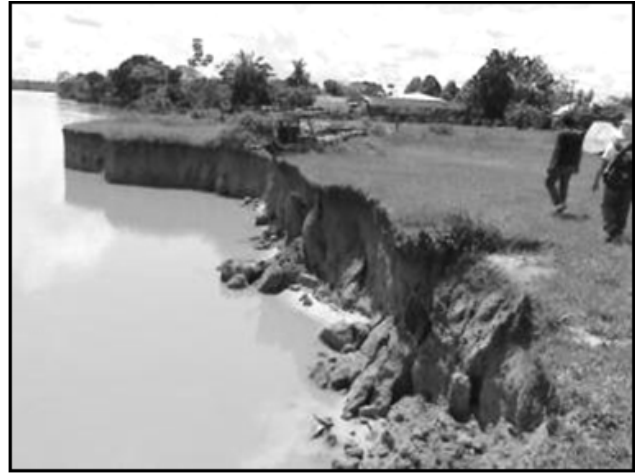
Figura 1.- Taludes Erosionados en margen derecha
