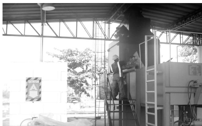
Figura 4. Operario introduciendo los residuos a la cámara de incineración. Fuente: Yepes A.
