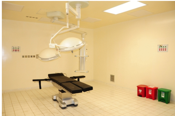
Figura 9. Foto sala de cirugía con módulos de fuerza-tierra (Yopal E.S.E, 2014).
