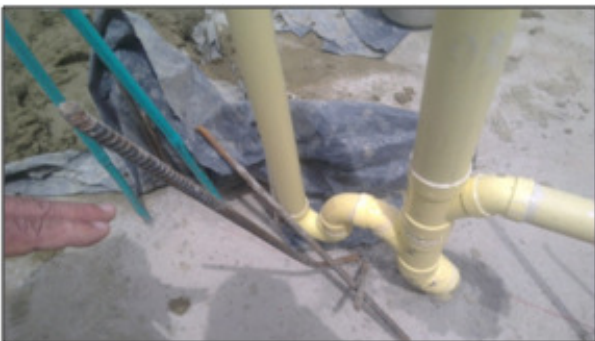
Figura 4. Refuerzo de dovela mal ubicada. Ubicación: Bloque E, piso 1, torre 10.
