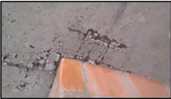
Figura 3. Oquedades en placa de concreto. Proyecto Belverde etapa I.
