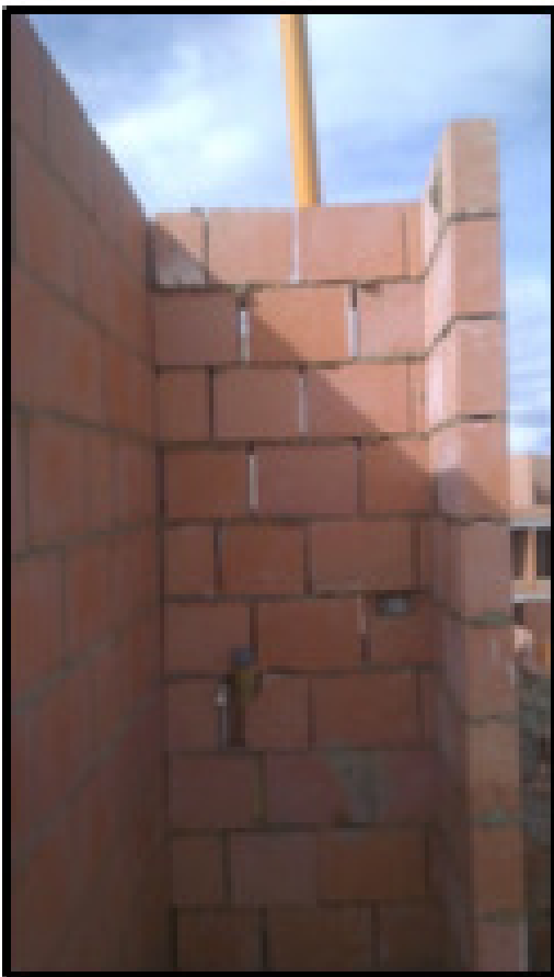
Figura 5. Juntas de mampostería sin rellenos. Ubicación: Piso 4, torre 5, bloque B.
