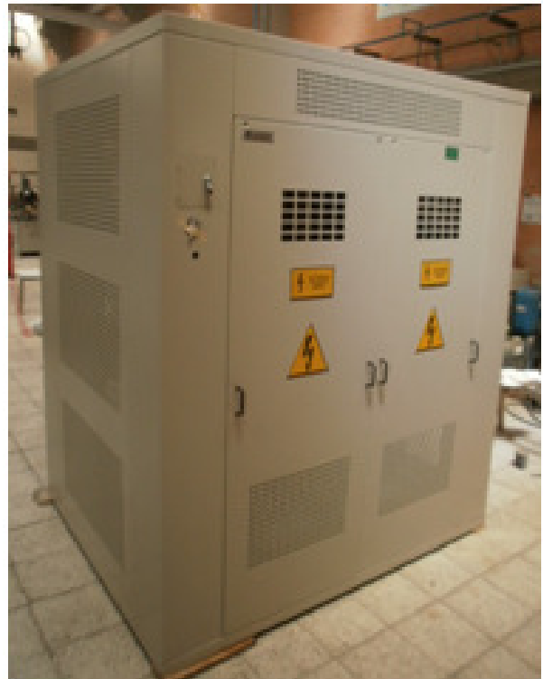
Figura 15. Fotografía celda con ventilación por agujeros punzonados.
