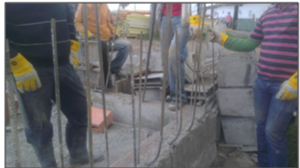
Figura 2. Viga de cimentación desplomada. Ubicación: Bloque E, torre 10, cimentación.
