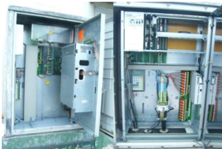
Figura 2: Controlador de tráfico siemens MR y SIEMENS C800V
