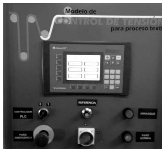
Figura 1. Panel de control de tensión para proceso textil
